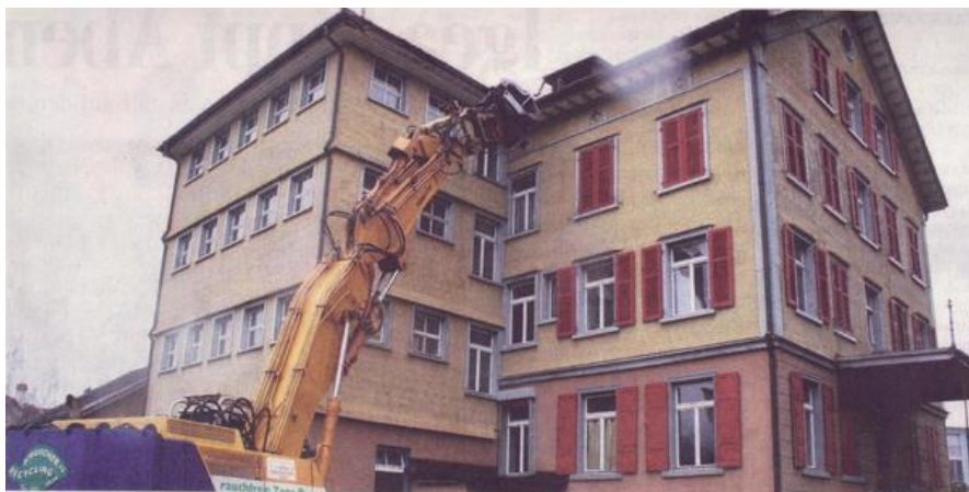
Bild: Reto Wälter Beginn des Abbruchs: Der Bagger greift sich als Erstes die Dachrinne und zieht sie vom Haus wie unsereins ein «Abziehbildl» von der Folie.
